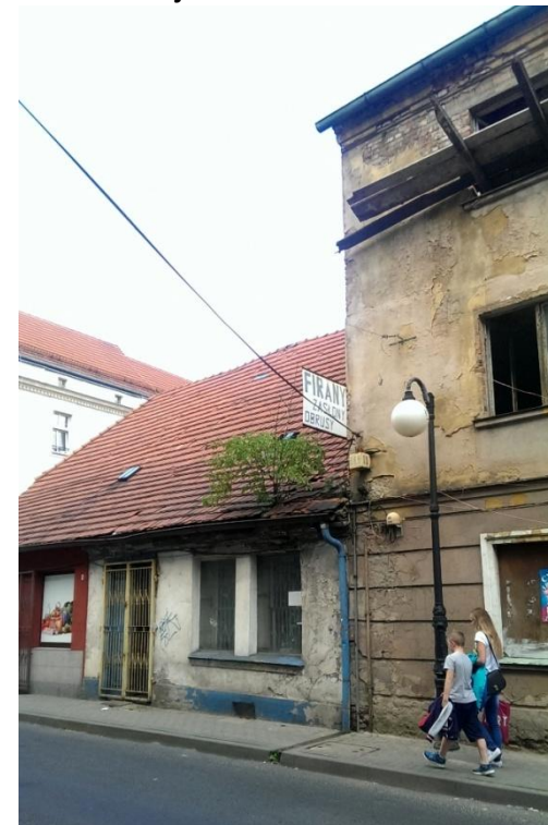
Fot. 19. Zniszczona elewacja budynku przy ul. Złotniczej 4-7
