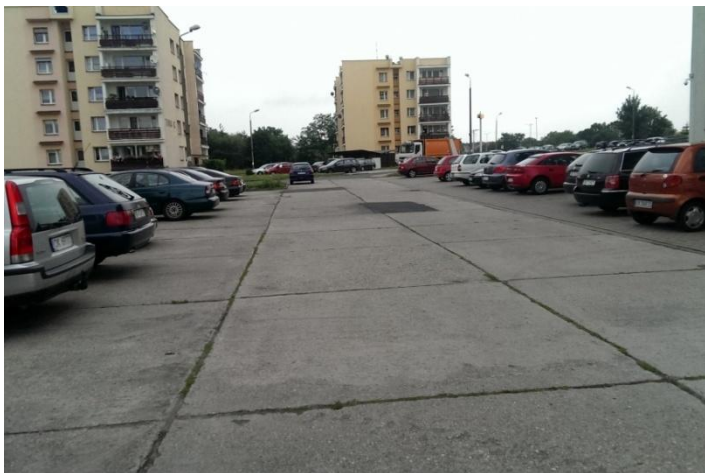
Rys. 41. Nawierzchnia parkingu przy ul. Tuwima 6
