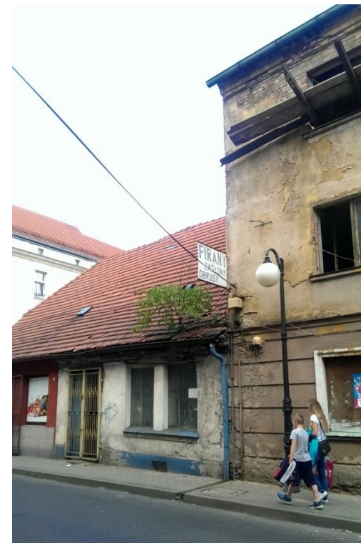
Rys. 59. Zniszczona elewacja budynku przy ul. Żłotniczej 4-7
