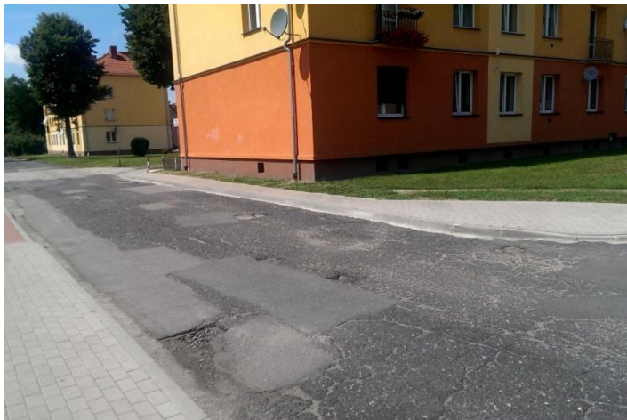
Rys. 67. Zniszczona nawierzchnia ulicy Grabskiego
